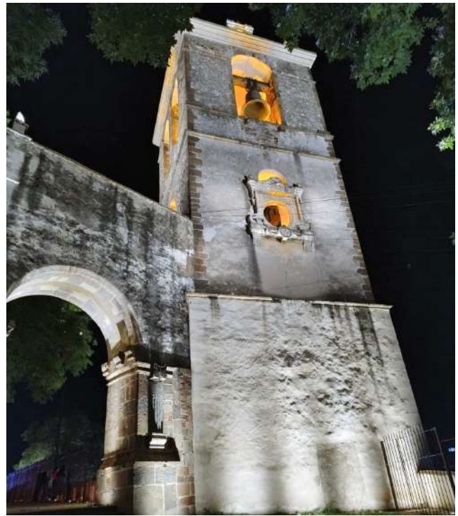
Torre exenta, Ex Convento Franciscano de Nuestra Señora de la Asunción, siglo XVI. Tlaxcala, Tlaxcala. Fotografía: José Vicente de la Rosa Herrera, 2024
